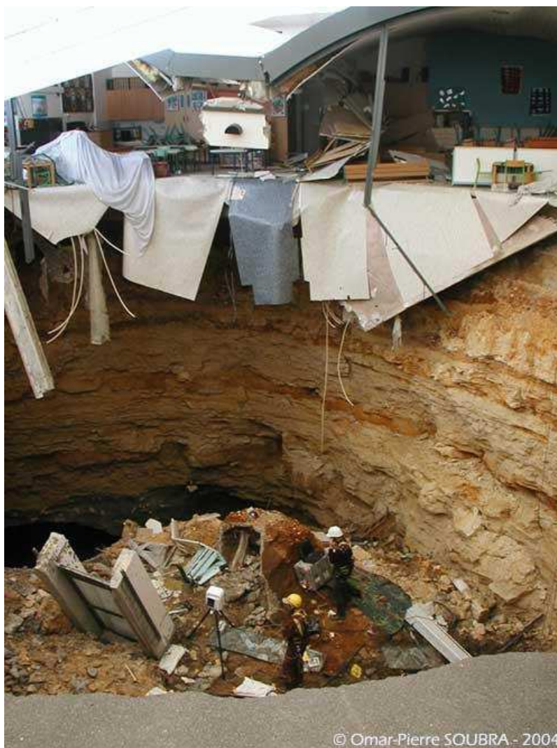
Effondrement de la cour d'école sur le chantier METEOR.
