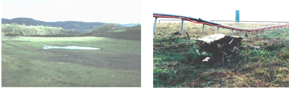
Figure 9. Illustration des tassements différentiels sur site (a) formation de dépressions sur la couverture de casier (b) apparition de points bas le long du réseau de drainage des biogaz (Source : ANTEA).
